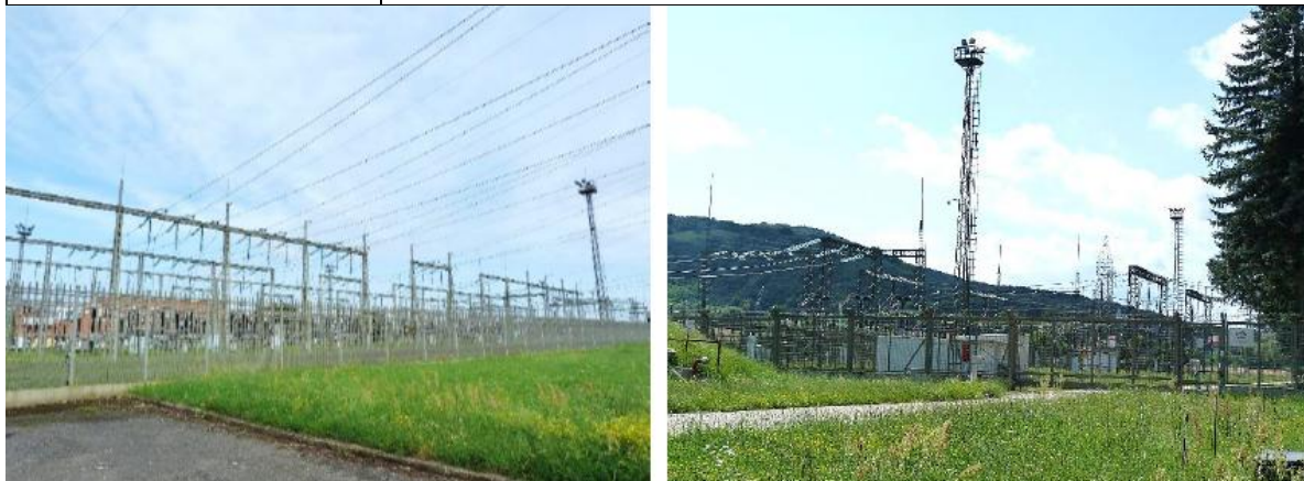
Felsőzsolca és Sajóivánka 400/132 kV-os alállomások
